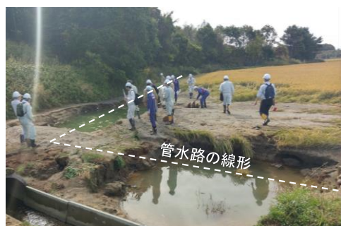
図-1 地震時における管水路曲管部の被害状況 (平成30年北海道胆振東部地震)
