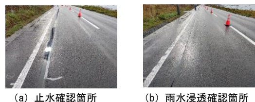
写真-2 止水対策施工箇所の止水状況（供用 2 ヶ月）
