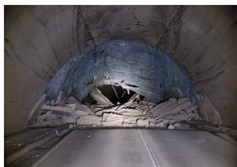
写真-2 中屋トンネルの被災状況 （北陸地方整備局提供）
