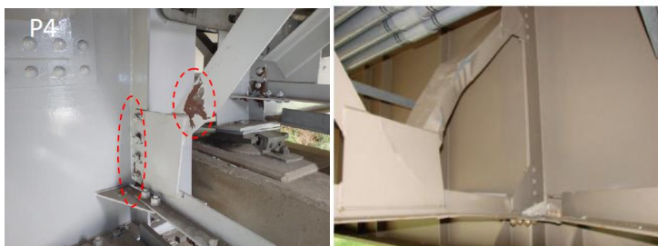
図-1 地震による鋼橋(対傾構)の損傷事例
