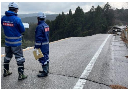
写真-1.2.1.3 崩壊した道路盛土の調査状況
