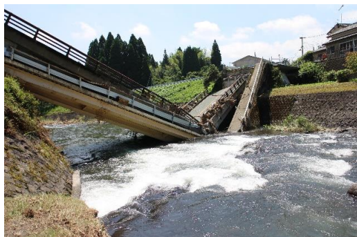
写真-1.2.1.7 落橋現場の現地状況
