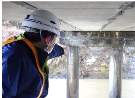
写真-1.2.1.2 損傷した橋梁下部の調査状況
