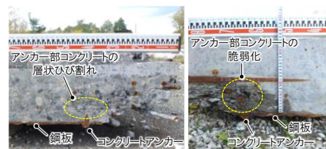
積雪寒冷地特有の補強済床版の損傷形態
