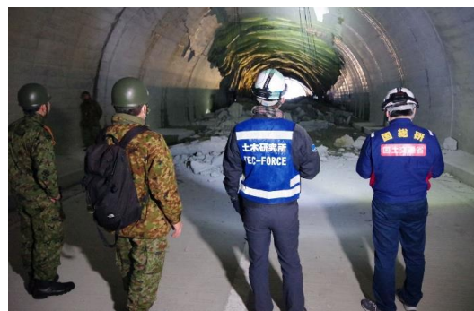
写真-1.2.1.4 大谷トンネルの覆工崩落箇所の調査状況
