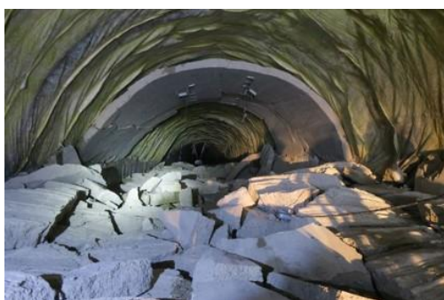
写真-1 大谷トンネルの被災状況
