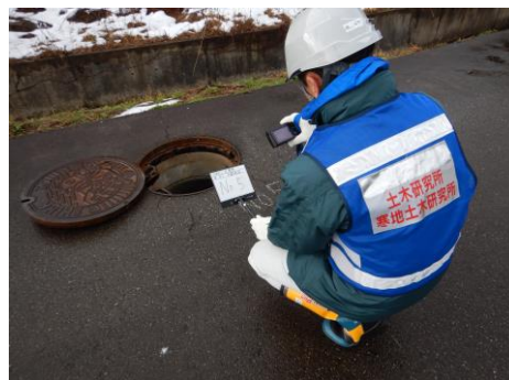
写真-1.2.1.6 農業集落排水施設における被害の調査状況
