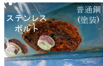
写真-2 異種金属接触腐食の例 ステンレス鋼 普通鋼（塗装）
