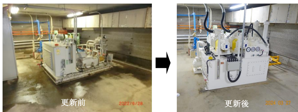
写真-8.1.1.1 構造物繰返し载荷装置油圧源外更新（つくば）
