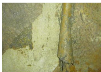
実際の剥離事例（生ゴミとの混合槽）
