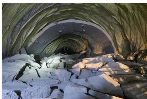
写真-1 大谷トンネルの被災状況
