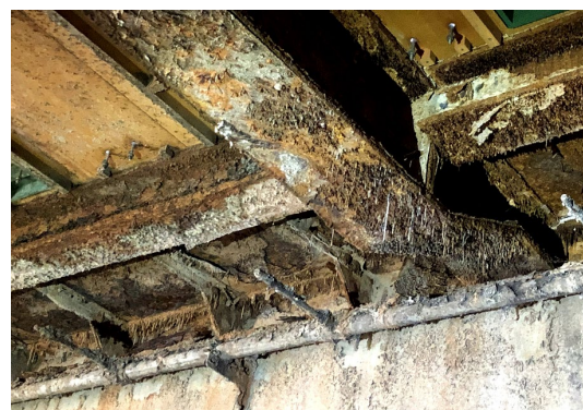
汚泥貯留槽の蓋を支える梁の腐食例
