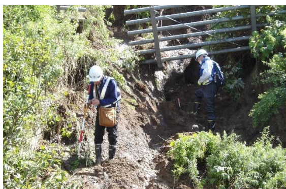
写真-1.2.1.3 切土のり面崩壊の発生状況
