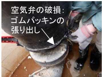
図1 地震時における空気弁の破損状況 (空気弁上部と下部に挟まれるゴムパッキングが張り出して漏水した)
