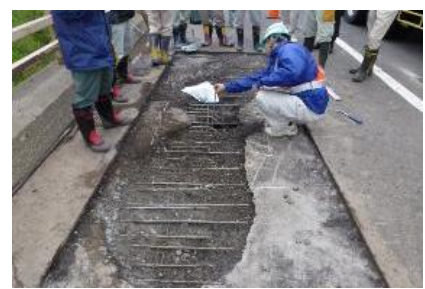
床版の土砂化
