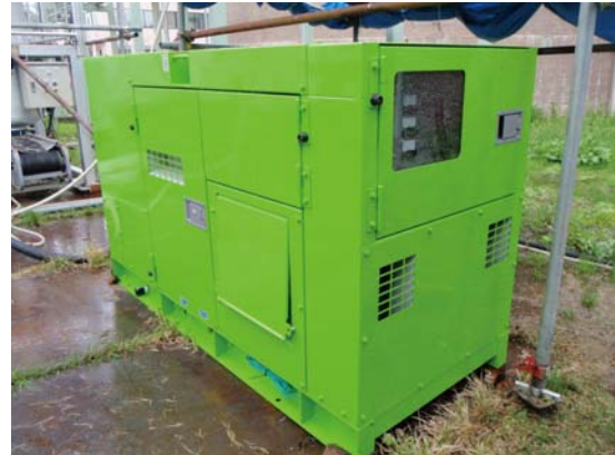
写真 消化ガスエンジン
