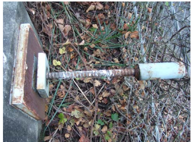
鋼棒タイプ 鋼棒の飛び出し
