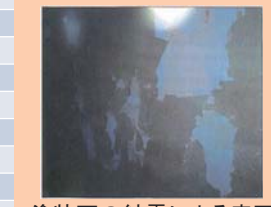
塗装面の結露による表面被覆材の剥離
