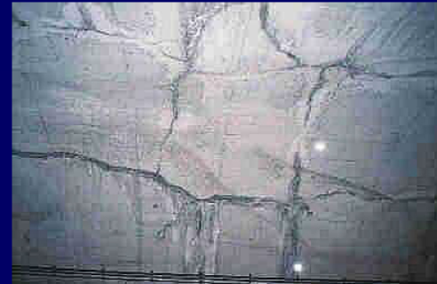
コールドジョイントとひび割れとの組合せでブロック化
