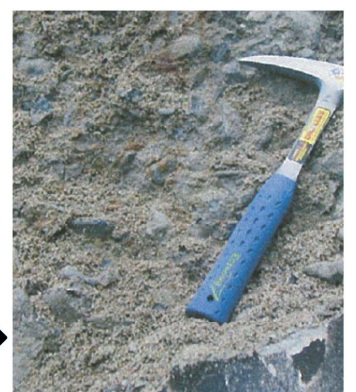
吹きつけモルタルの土砂化→
