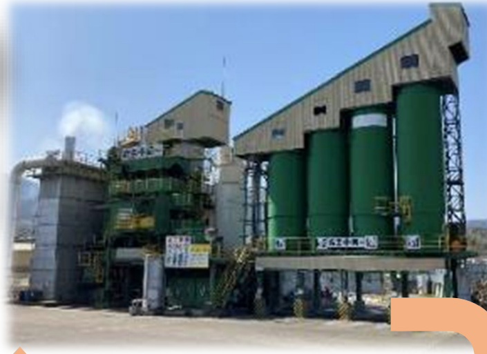
アスファルト混合物プラント
