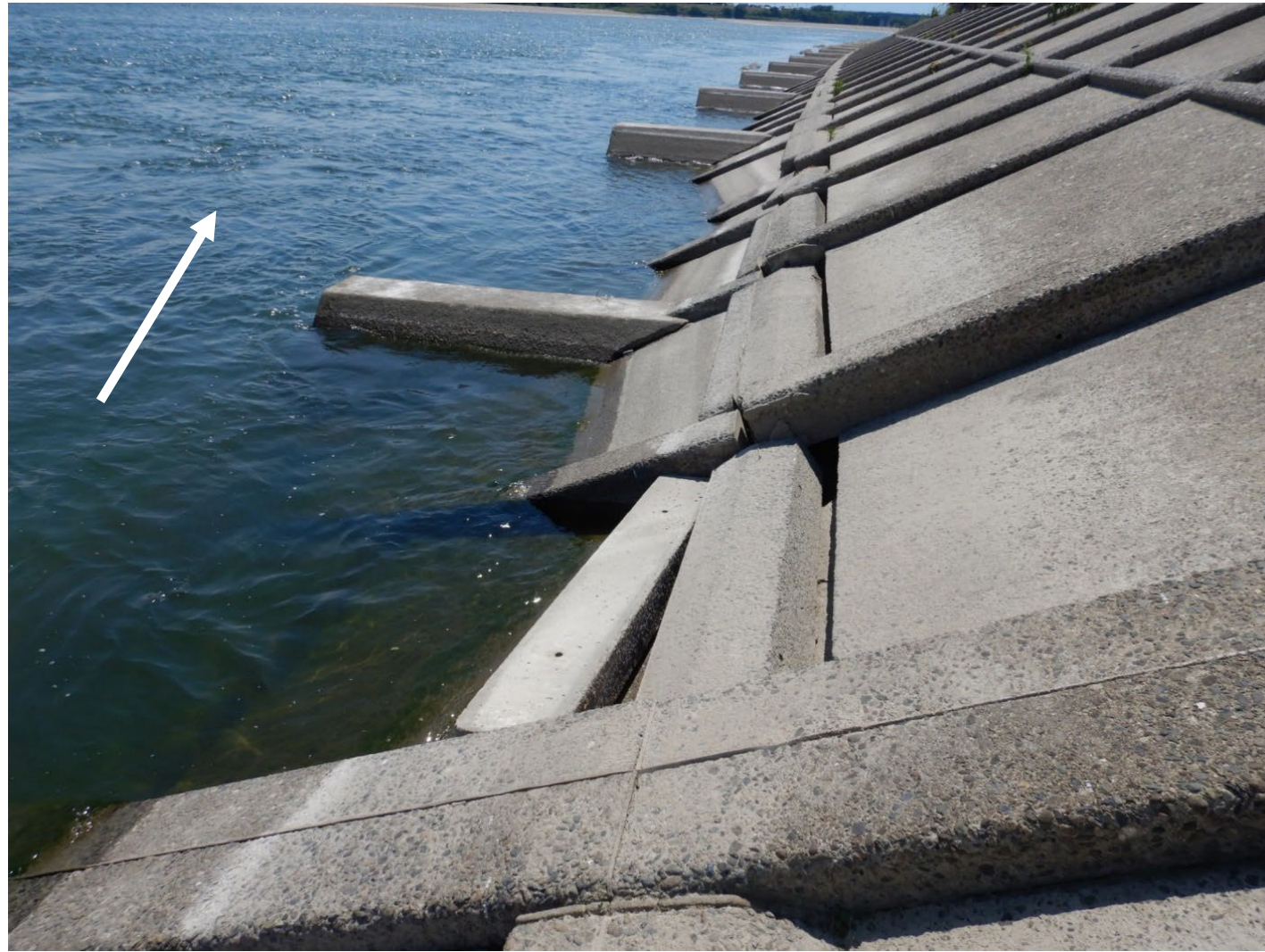
図2.8 木曽川右岸の護岸の被災（2022年5月）
