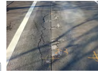
比較工区で発生した損傷(舗装走行実験場)
