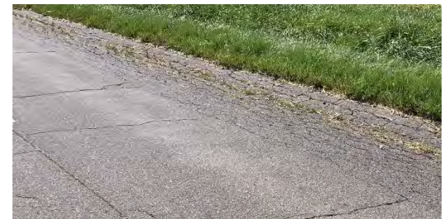
沈下・亀甲状ひび割れ
