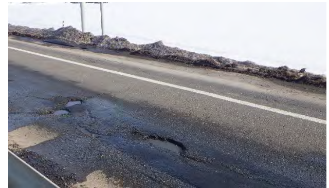
ひび割れ・ポットホール
