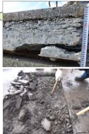
橋梁床版の劣化損傷の事例
