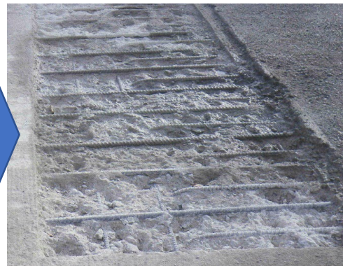
床版上面の土砂化
