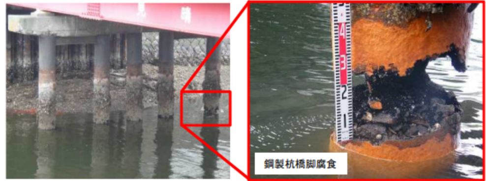
【重大な損傷の事例(橋梁)】
