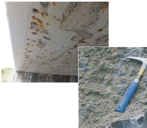
補修の不具合事例
