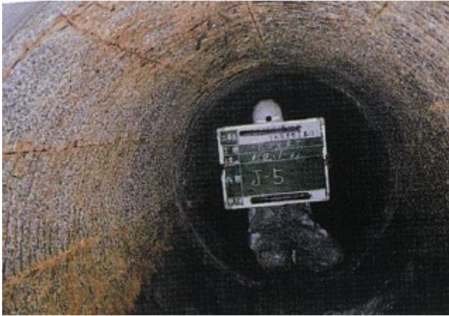
腐食(鉄筋露出)
