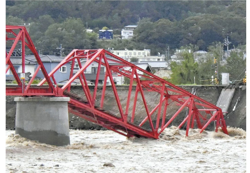
崩落した別所線の鉄橋（2019年10月13日撮影）
