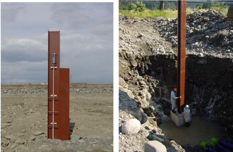
参考写真1 砂面計の設置状況（姫川）
