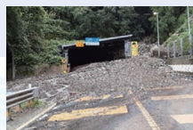
豪雨時の土砂流出の例 (写真提供: 福井河川国道事務所)
