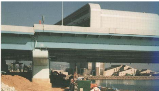
写真-1 液状化によって落橋寸前となった事例
