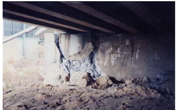
写真-2 液状化による橋台の重大な損傷
