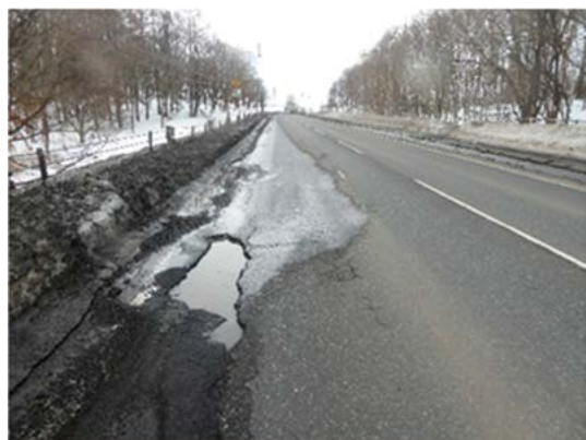
凍結融解による舗装損傷
