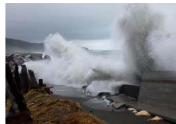
高波による海岸護岸の被災
