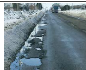
ポットホールの発生状況
