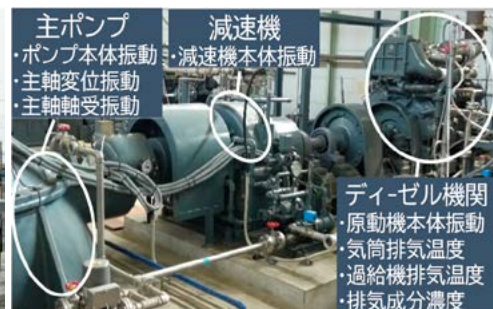
運転データを自動取得する状態監視モニタリングシステムを設置した排水機場ポンプ設備
