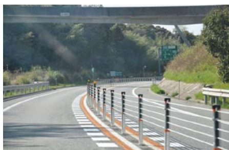
設置状況：浜田自動車道
