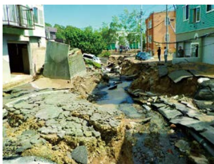
液状化による住宅地の被害
