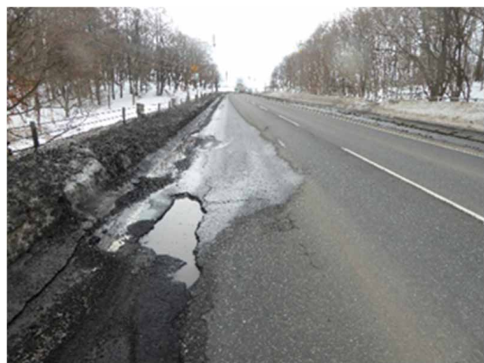
凍結融解による舗装損傷
