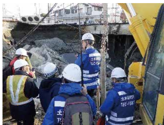
令和7年1月 埼玉県八潮市道路陥没事故対応、 緊急対応から将来のインフラマネジメント・点検基準見 直しまで総合的に支援
