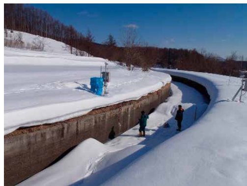
寒冷地特有の凍結融解作用等により劣化した農業用開水路の劣化調査
