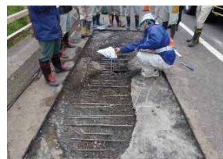
床版の土砂化
