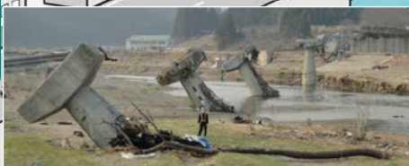
津波による橋梁流失・下部構造被害
