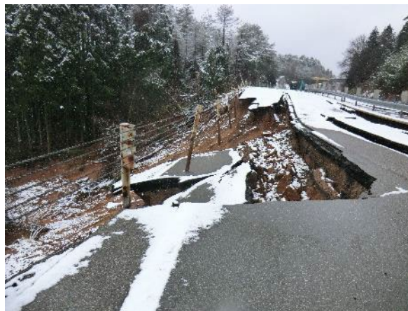
写真2 のと里山海道における盛土変状
