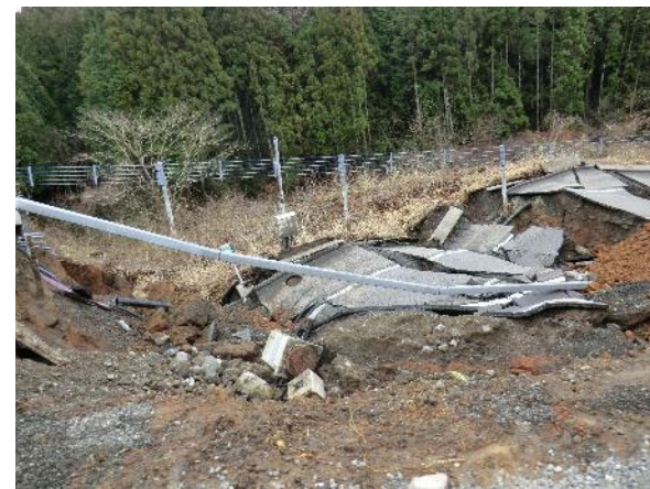
写真3 能越自動車道における盛土変状
