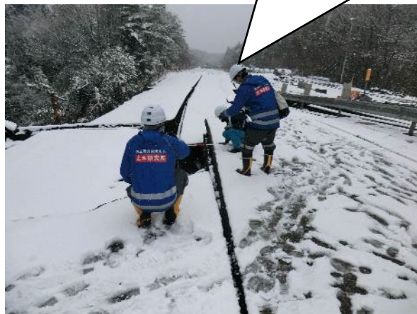
写真1 のと里山海道における盛土変状調査状況
