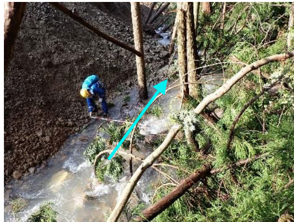
河道閉塞の通水状況
