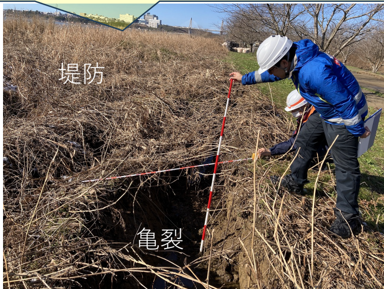
写真1 河北潟河川構造物等被災状況調査
