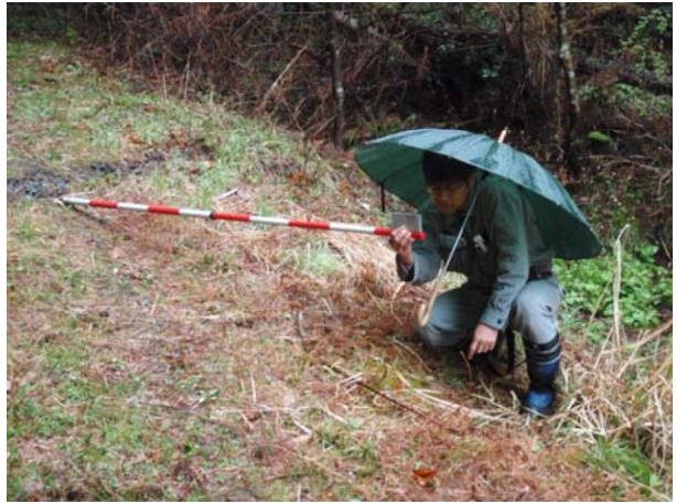
たわみの状況。とう曲幅は2m、沈下量は60cm程度。
