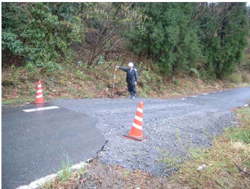
道路に亀裂。走向はN25W。
