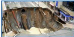
←福岡市地下鉄七隈線延伸工事現場での道路陥没 陥没の大きさ 幅約27m×長さ約30m×深さ約15m
