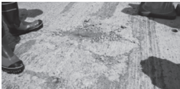
コンクリート床版上面で生じる土砂化の様子
