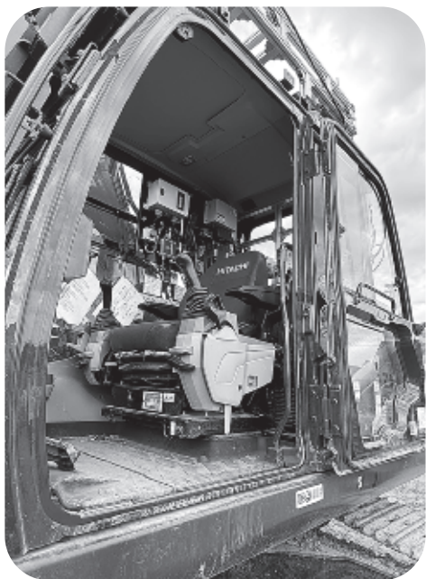
コントローラーなどが設置された油圧ショベルの操縦席
