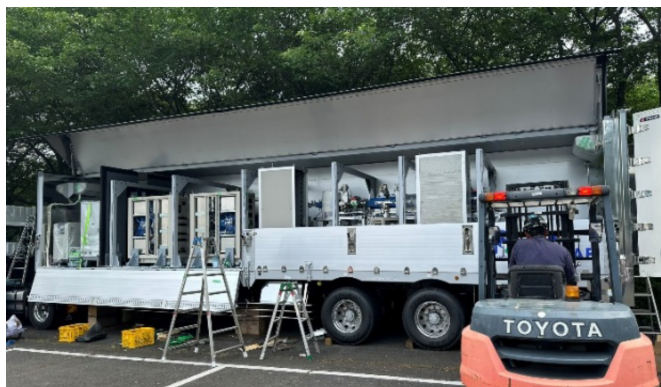
図4 中性子発生用加速器及び付帯設備の設置状況
