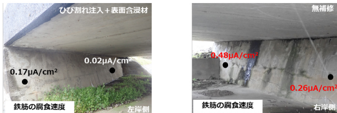
補修部は無補修部に比べて1/10以下の腐食速度
