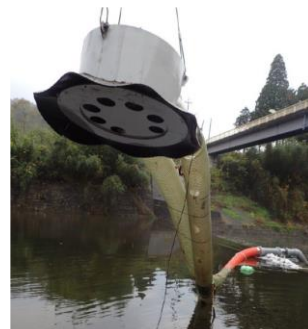
サイホン効果を用いた 潜行吸引式排砂装置
