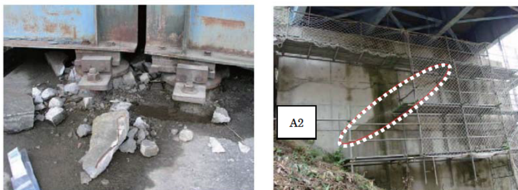
支承の沓座モルタルの損傷，橋台壁に斜めひび割れ(幅 5mm 程度)
