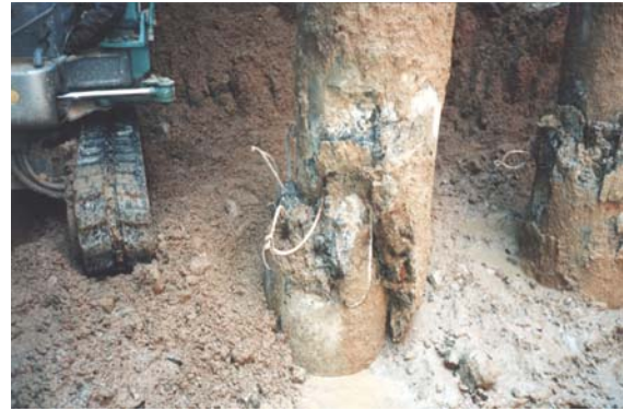
PC 杭のせん断破壊 (平成 7 年兵庫県南部地震 東灘下水処理施設)
