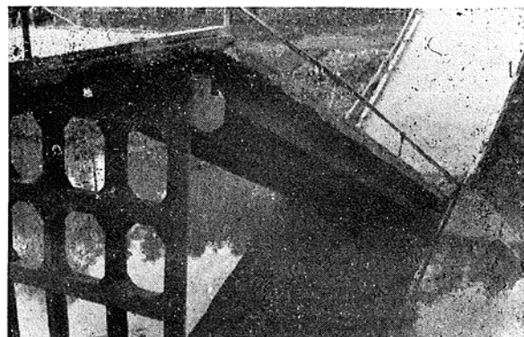
写真-4.5 辨天橋（落橋） 19)
