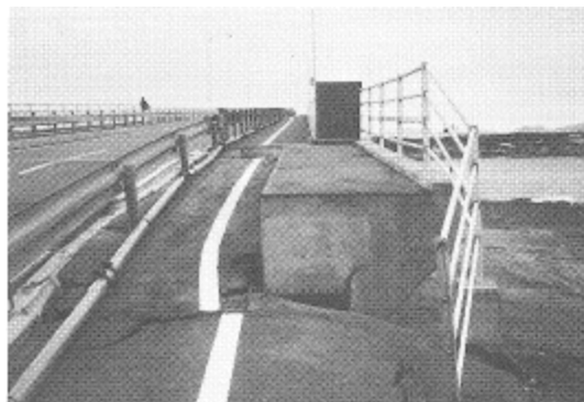
写真-4.15 十三湖大橋 (A1 橋台背面 ; 液状化による橋台裏込め土の沈下) 30)
