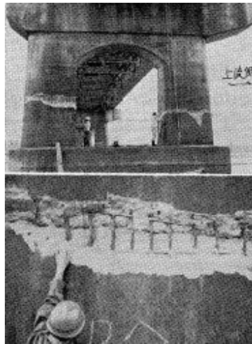
写真-4.11 阿武隈橋（橋脚躯体の亀裂，損傷）29)
