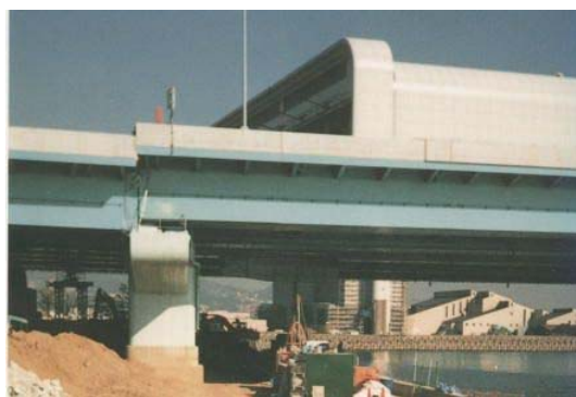
写真-4.17 阪神高速 5 号湾岸線 新夙川橋 （流動化による下部工移動） 45)
