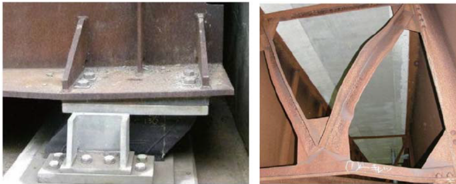
ゴム支承の変形 (左), 横構・対傾構の座屈 (右) (地震直後 27)
