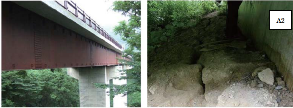
赤倉沢橋全景 (左), A2 橋台前面の地割れ(右)
