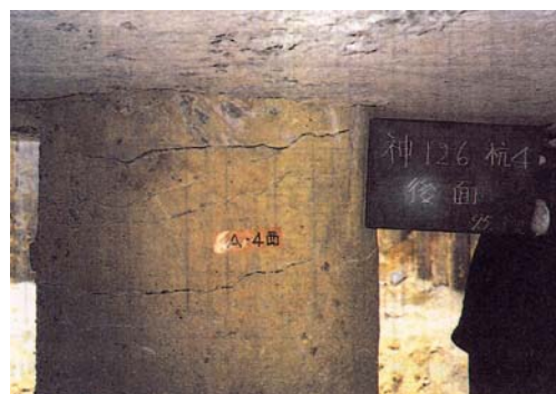
場所打ち杭の状態：軽微な曲げ亀裂
