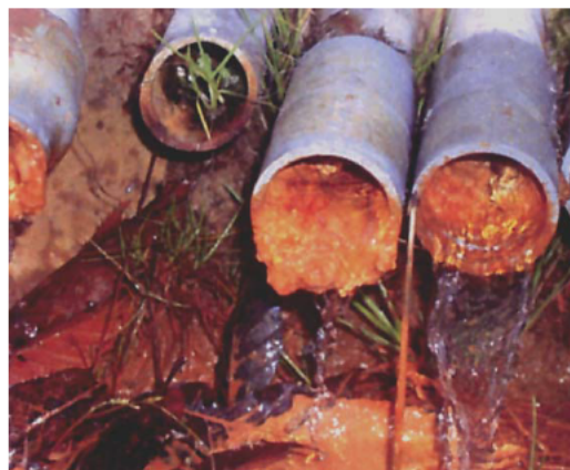
写真-15 閉塞した横ボーリング
