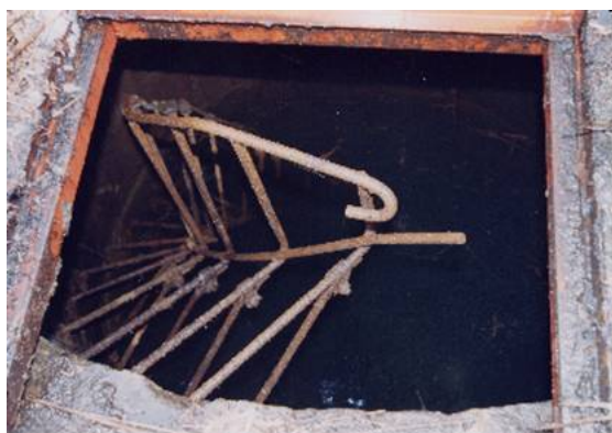
写真－１０ 集水井内に入るためのタラップの腐食
