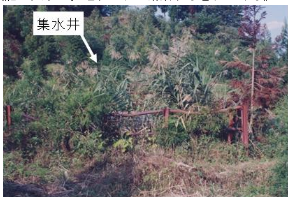
写真－８ 草木で覆われた集水井
