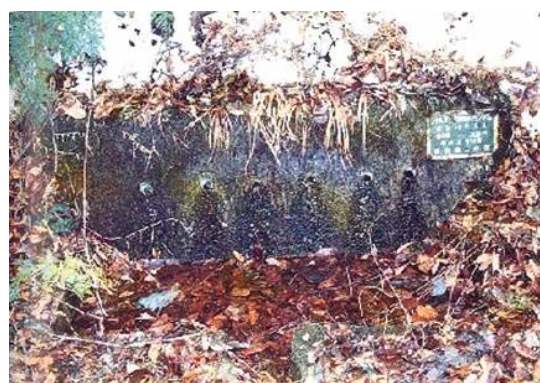
写真－６ 木の葉等が堆積した集水マス
