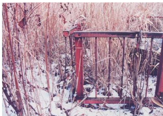
写真－１１ 破損した柵
