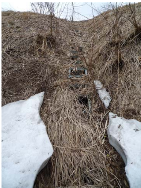
写真－1 草が水路内に倒れ込んだ水路
