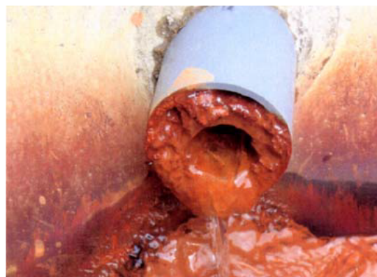
写真-17 閉塞した集水管A
