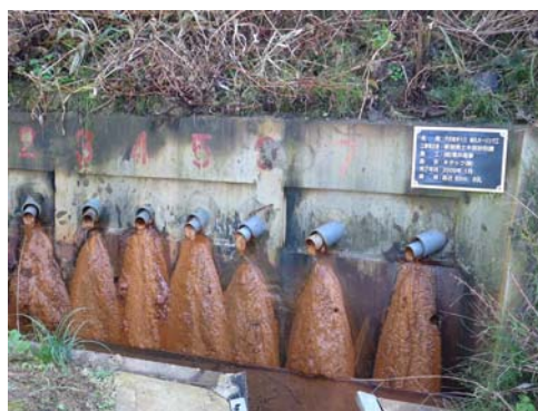
写真－７ 閉塞物が付着した集水管
