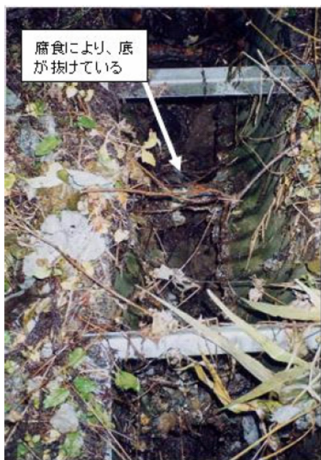
写真-3 腐食により底が抜けた鋼製
