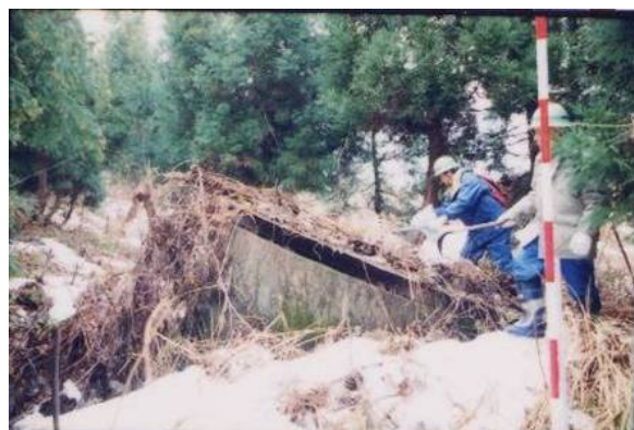
写真－９ 傾いた集水井
