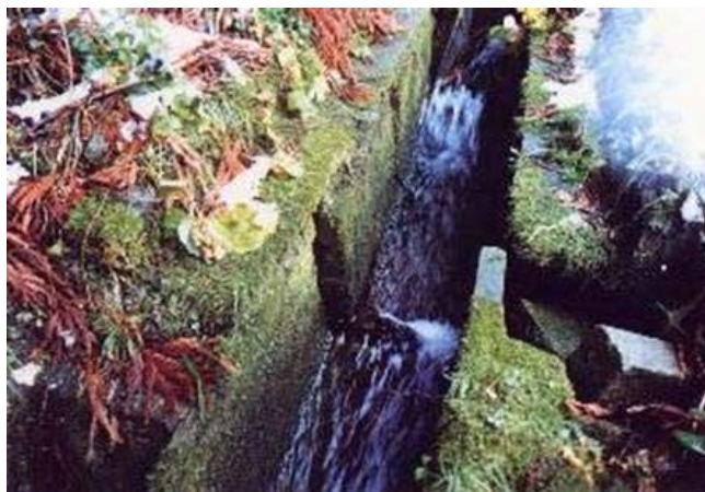
写真－2 水路の接合部の目地が取れた水路
