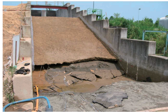
写真-3.20 流出したアスファルト
