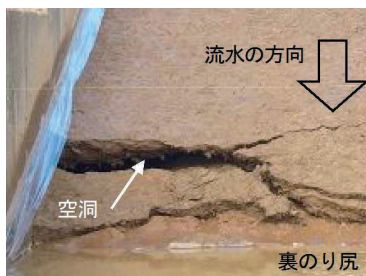
写真-8 保護工下の空洞
