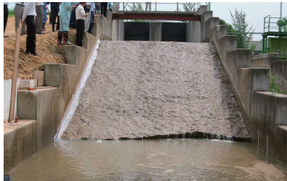
写真-3.18 越水5分後の状況
