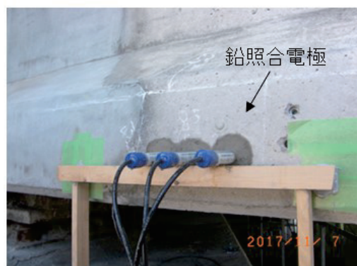
図－6 PCT 桁橋でのセンサ設置 （断面修復後のモニタリング）
