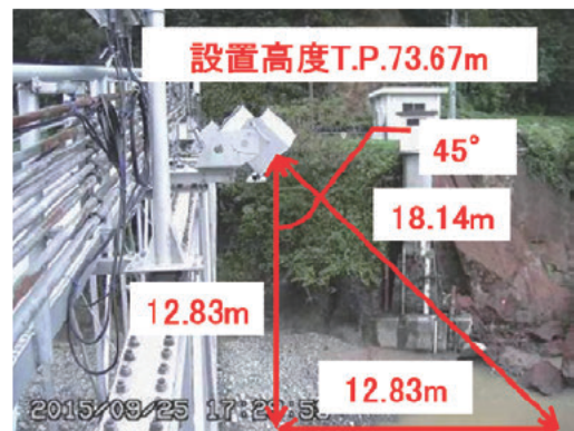
写真－2 電波式流速計の設置例
