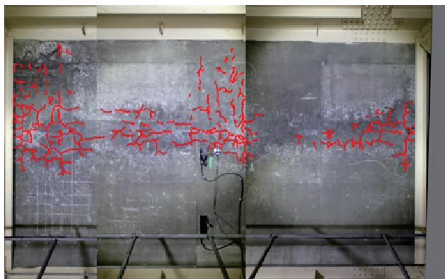
図－4 ひび割れ分布図の一例
