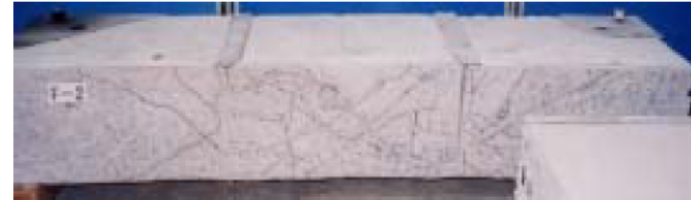
ひび割れ図(F2, コンクリート, a_a断面)
