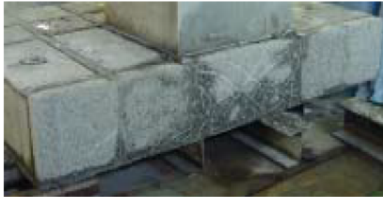
ひび割れ図(F1, コンクリート, a_a断面)
