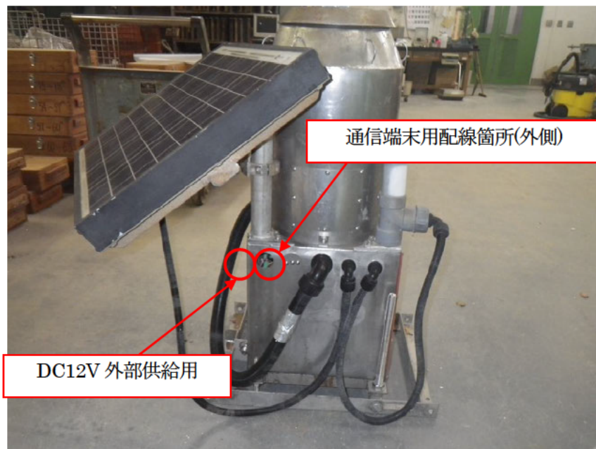
図 8 通信端末、外部電力供給箇所
