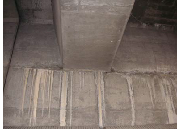
写真 3.4.2 コンクリート桁打継目の遊離石灰の析出
