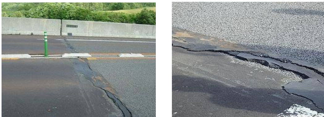
写真 1.2.1 橋台背面の舗装の損傷例
