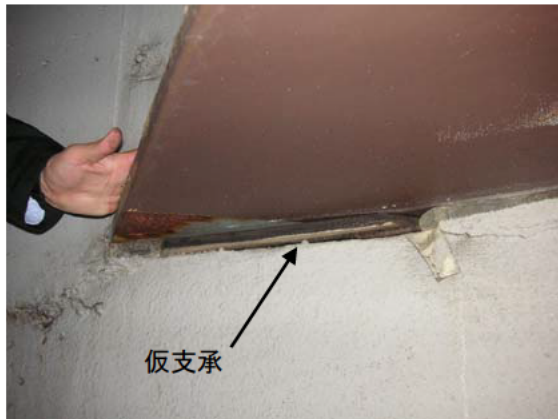
写真 3.4.1 鋼板桁下面に生じたひび割れ
