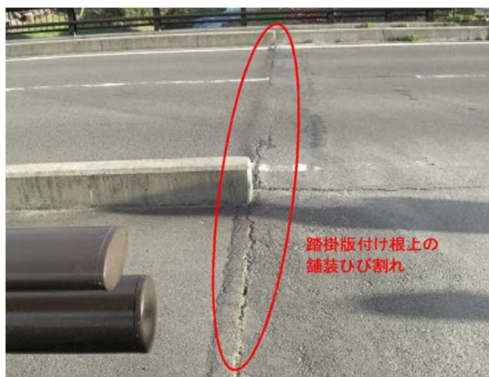
写真 2.4.1 踏掛版境界上の舗装ひび割れ状況
