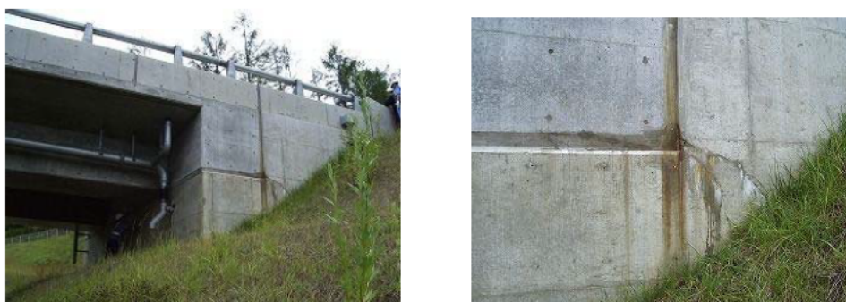
写真 2.3.1 上部構造と橋台たて壁の接合部付近の損傷
