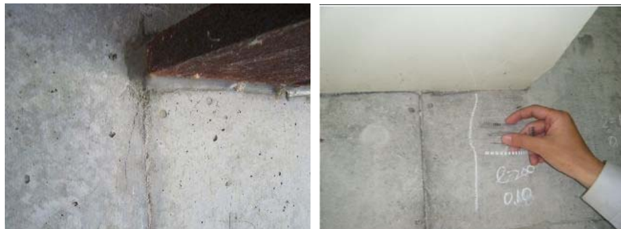
(A) 下フランジ先端部からのひび割れ (B) 下フランジからのひび割れ (A)以外
