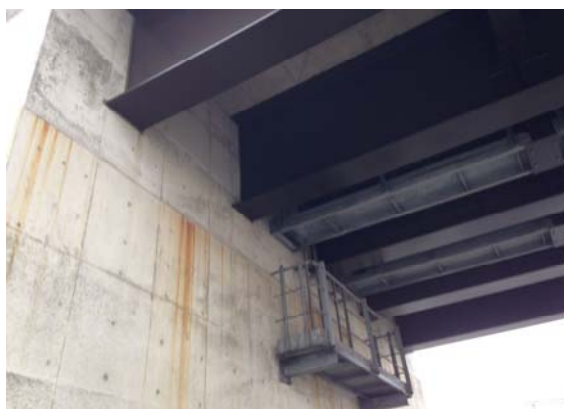
写真 6.1.1 さび汁による橋台の汚れ
