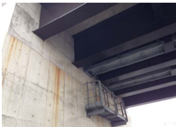
写真 3.4.5 さび汁による橋台の汚れ
