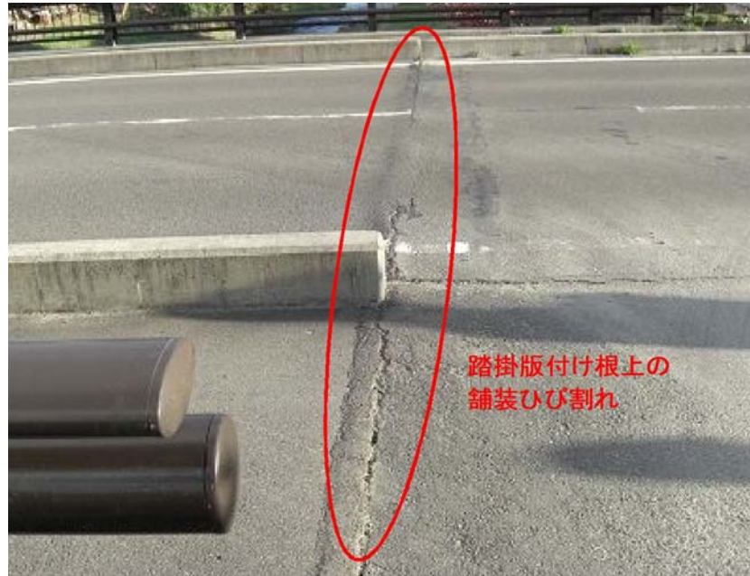
写真 6.3.1 踏掛版境界上の舗装ひび割れ状況
