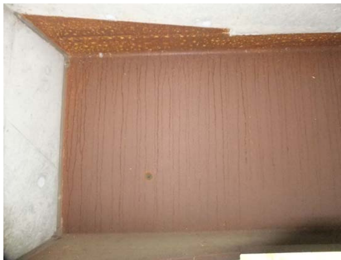
写真 6.1.4 耐候性無塗装橋梁における桁端部の発せい状況
