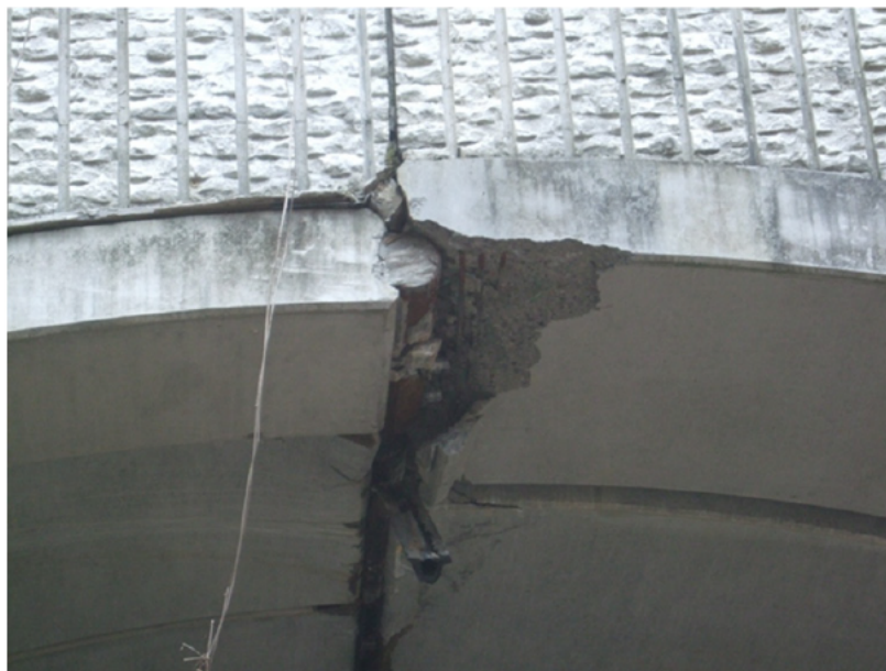
(b) 天井部の接合部の損傷
