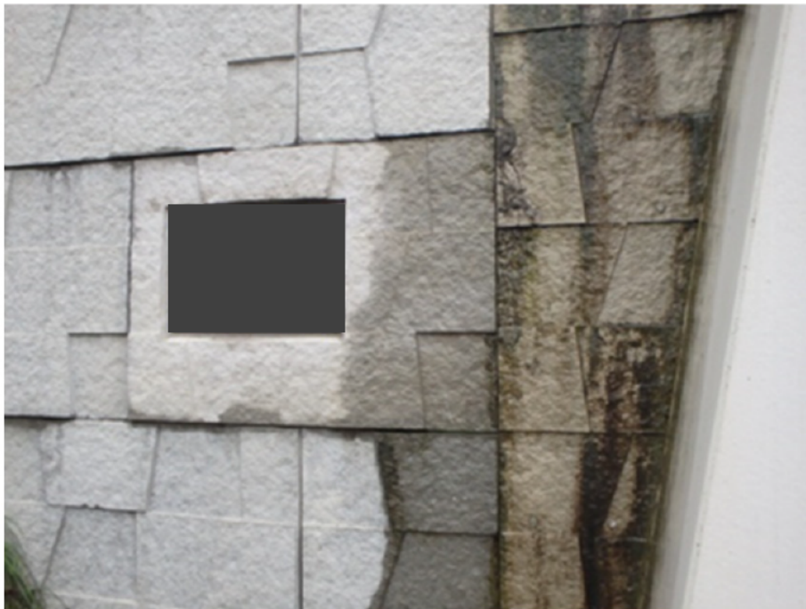
写真-2.14 面壁からの漏水状況
