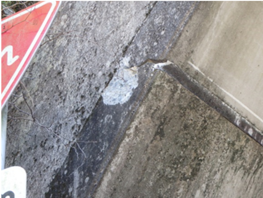
写真-2.2 ヒンジ部の剥落
