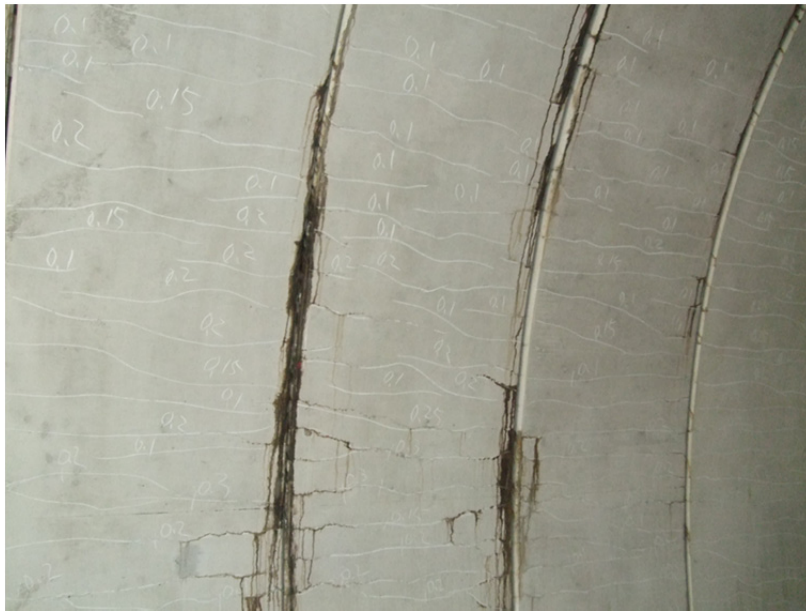
(a) ひび割れ
