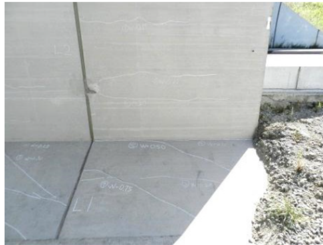
写真-4.2.3 事例3の損傷状況 (参考文献3より転載)
