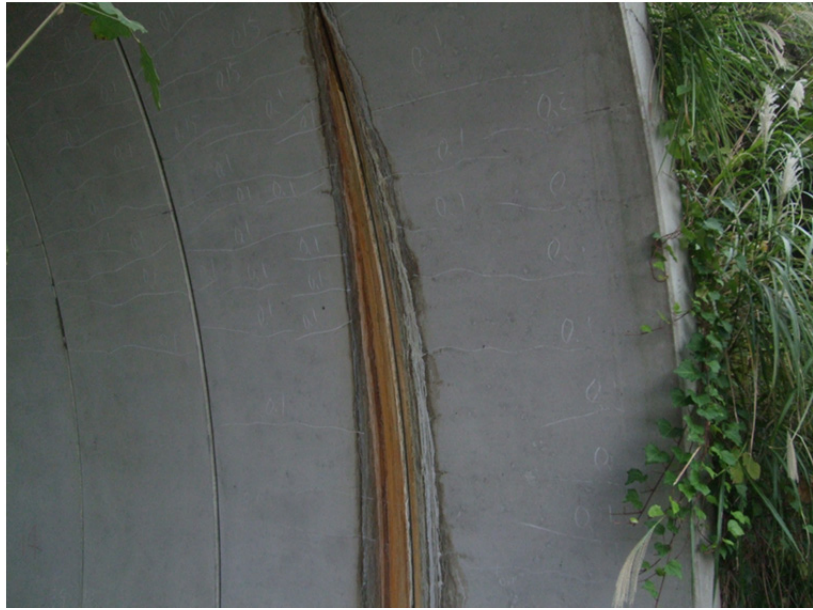
(a) 部材接合部の漏水
