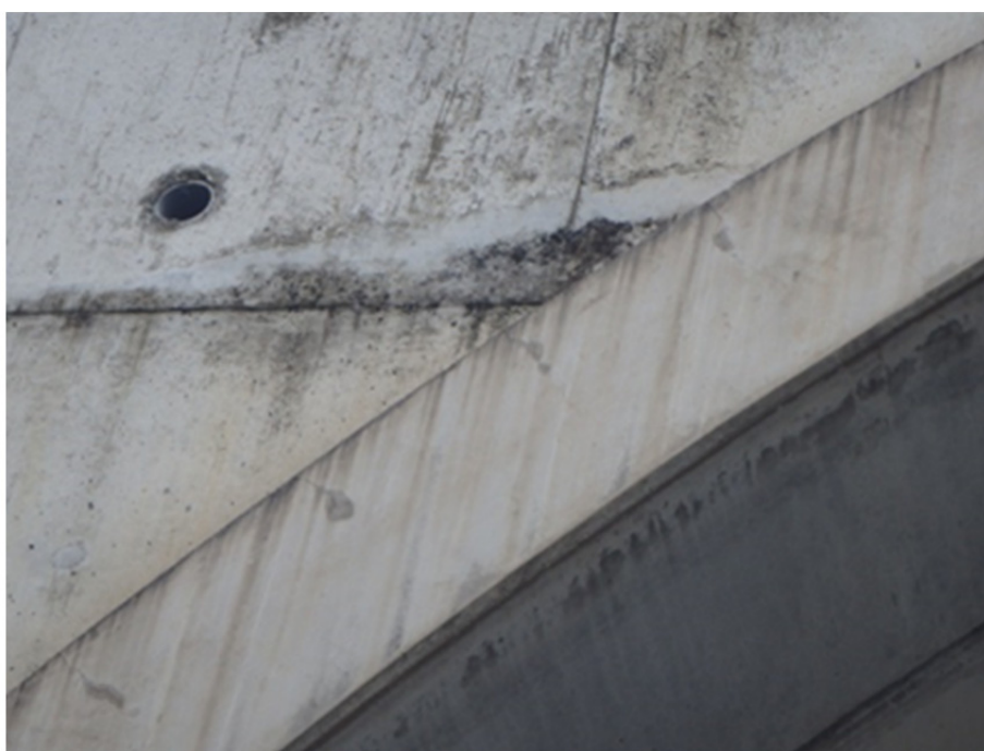
写真-2.17 アーチ外側の曲げひび割れ
