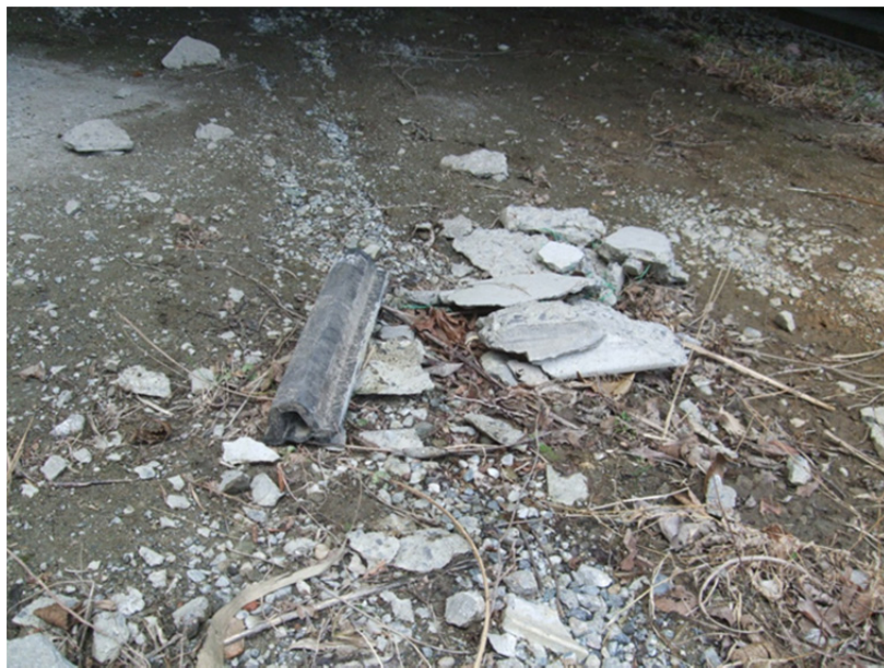
(b) 剥落したコンクリート片
