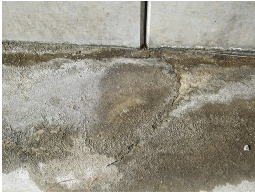
(b) 基礎部材のひび割れ
