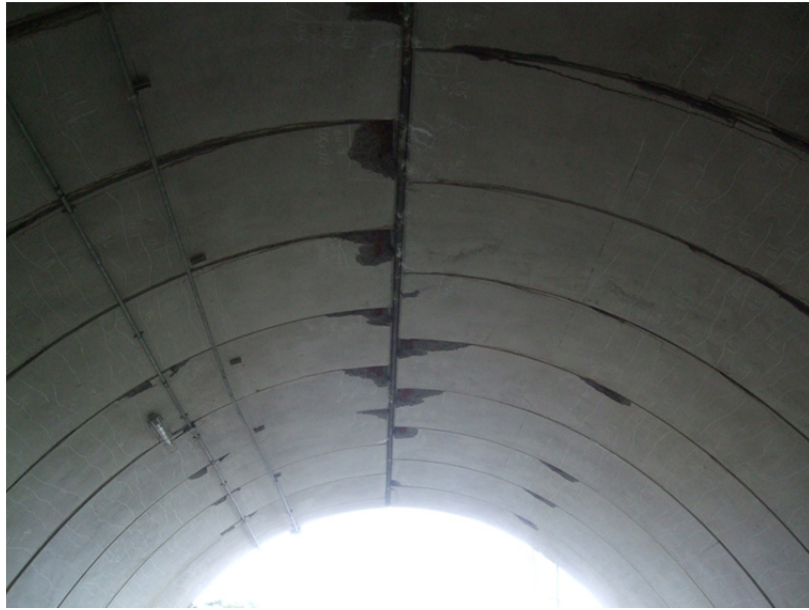
(a) 天井部の接合部の損傷
