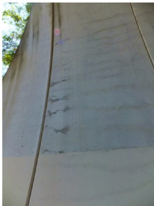
写真-2.8 側壁の曲げクラック
