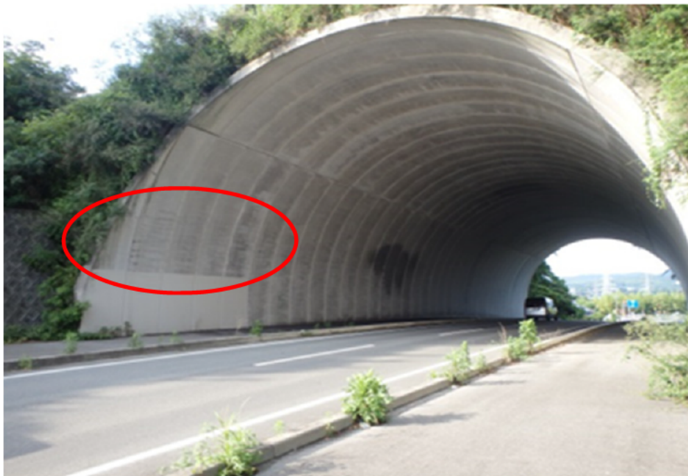
写真-2.7 側壁の曲げクラック（赤丸箇所）
