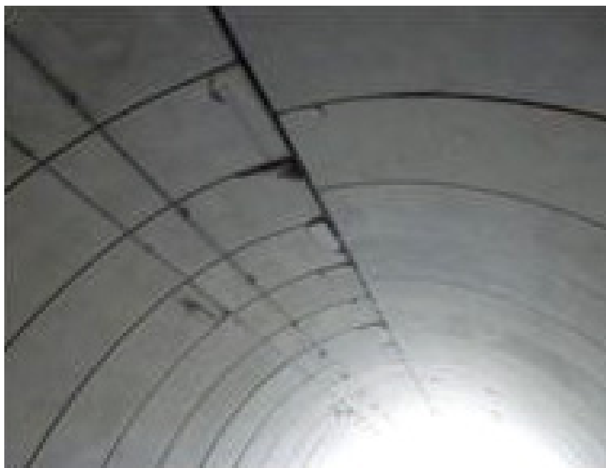
写真-4.1.1 アーチ天井部のコンクリート片の剥落[参考文献2より転載]
