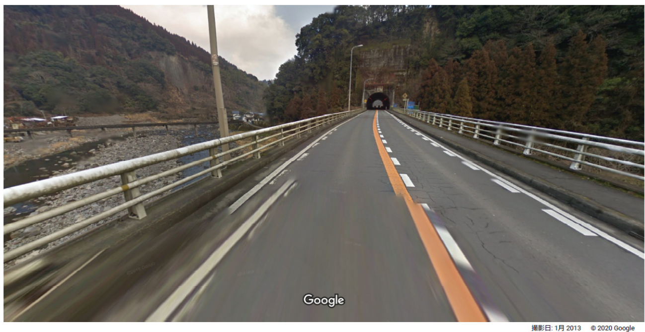
図-5.4.1 A1-P1 間、プレートガーダー区間の路面ひび割れ 11)
