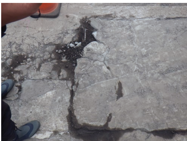
(c) 床版上面，損傷部，鉄筋露出 拡大
