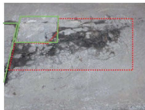
(c) 床版上面の損傷状況
