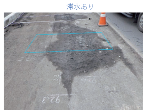
(b) 舗装開削直後の滞水状況
