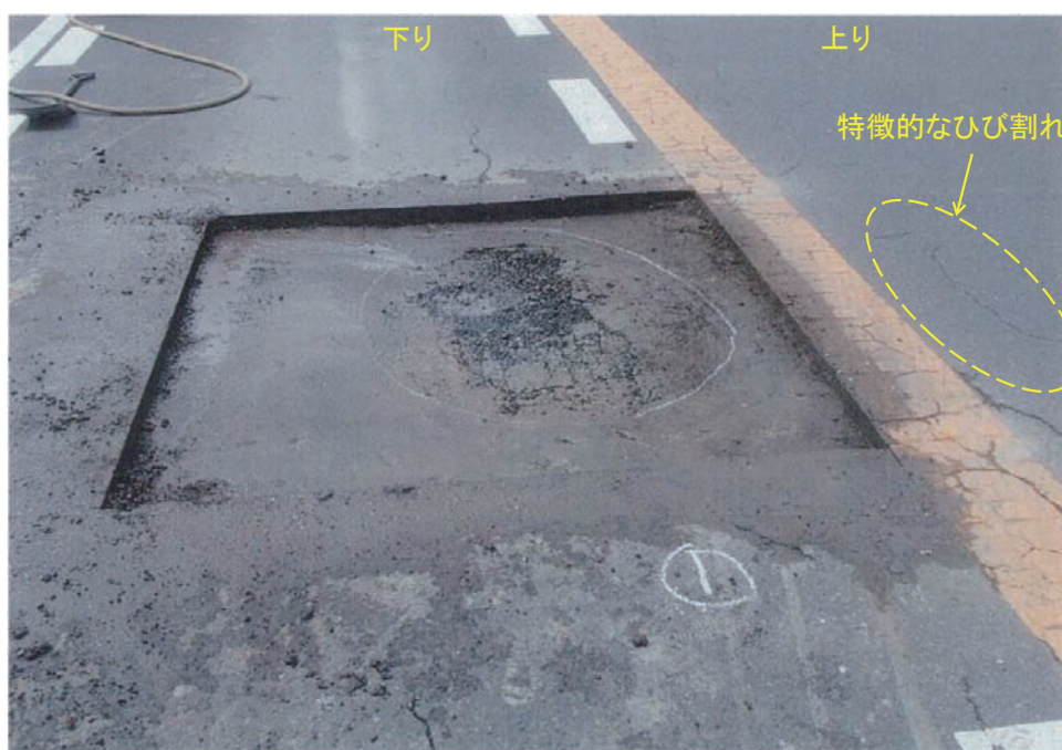
(b) 補修直前の床版上面, 2015 年 9 月
