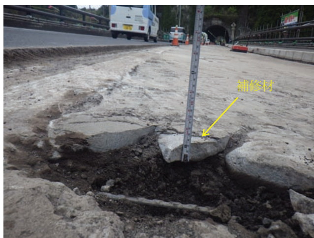
(d) 床版上面，損傷部，補修材の下
