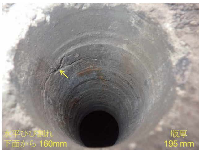
図-4.1.18 P1-P2 間床版の貫通孔
