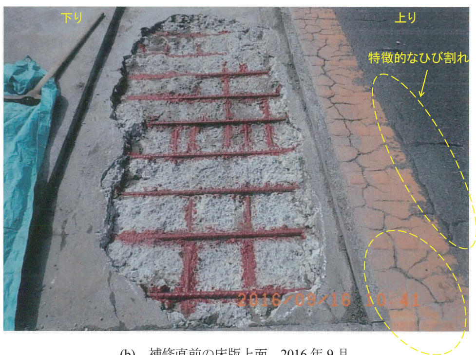
(b) 補修直前の床版上面，2016 年 9 月
