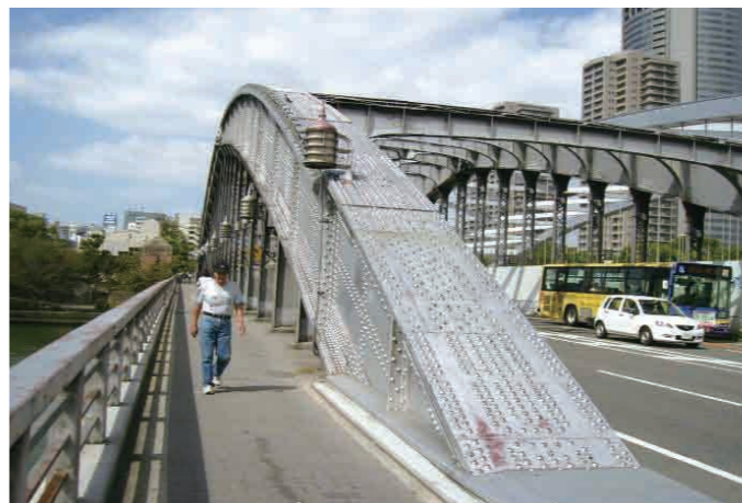
施工前の桜宮橋は部分的に塗膜のムラやひび割れなどがありました。
