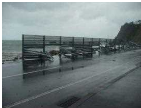
写真-1 板材の破損状況
