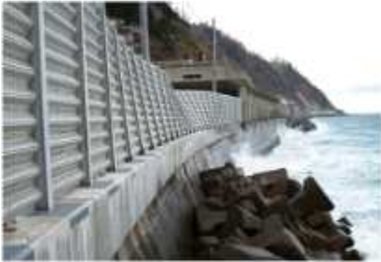
写真-2 支柱の折れ曲がり状況
