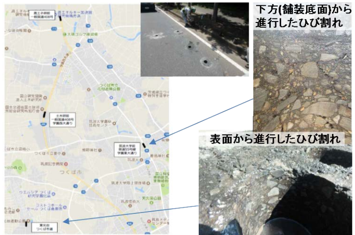
図5-1 ひび割れ形態の異なる破損（つくば市内試験舗装区）
