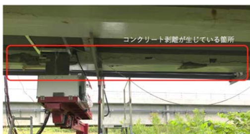
図-2.2 主桁下フランジのひび割れ・剥離
