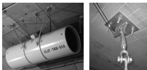
図-1 ジェットファンの取付け状況の例
