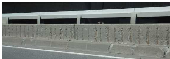
写真-1.1 都市部壁高覧における鉄筋腐食事例
