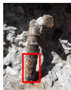
写真-5.2 鉄筋の腐食状況
