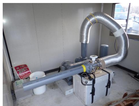
図-4 曝気ポンプの流量測定
