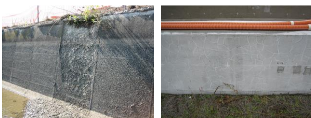
開水路側壁の断面欠損 無機系被覆材のひび割れ 図-47 コンクリートの凍害と補修材の早期劣化
