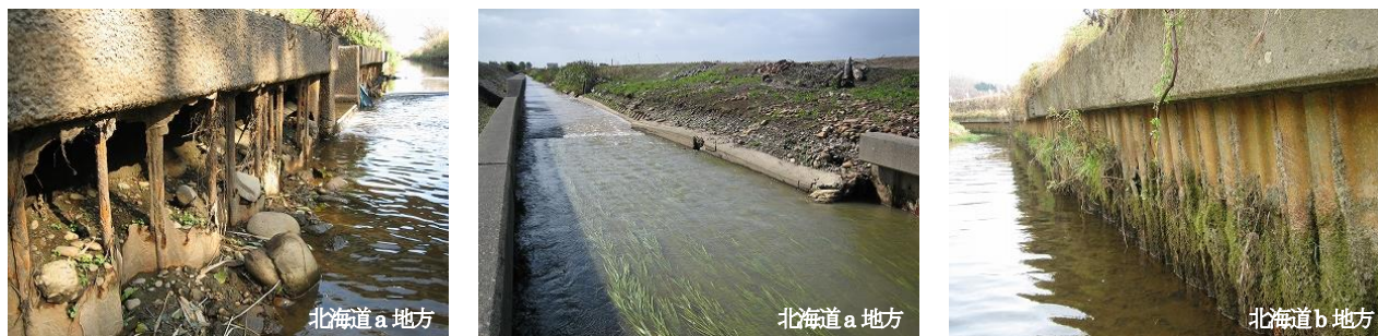
図-12 北海道内における農業用排水路を構成する鋼矢板の腐食
