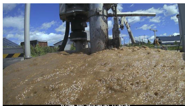
図-26 施設Iでの泡溢流停止直後の状況 (2018/9/2 11:07)
