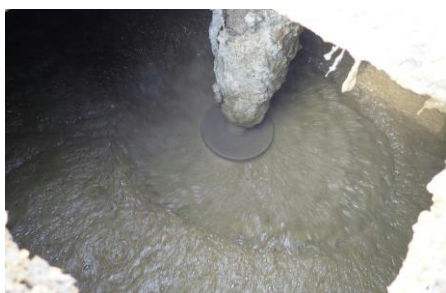
図-3 稼働中の消泡機
