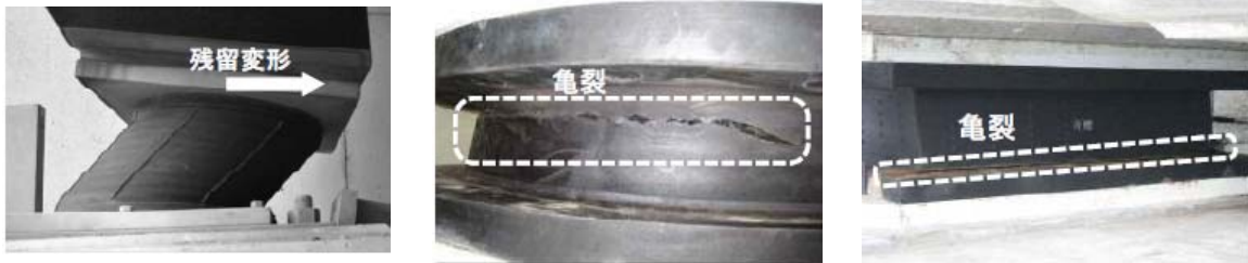
図-2.9 ゴム支承の撤去前の損傷状況(左:扇の坂橋 A2-G1、中:旭高架橋 As1G1、右:旭高架橋 P1G2)
