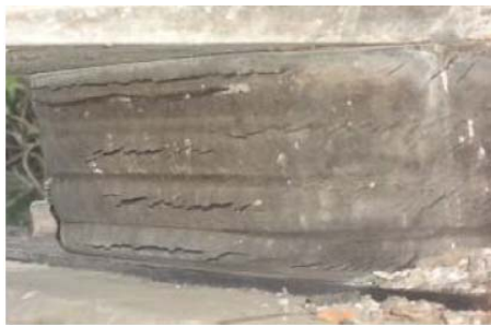
図-2.1 オゾン劣化によると思われる支承の亀裂
