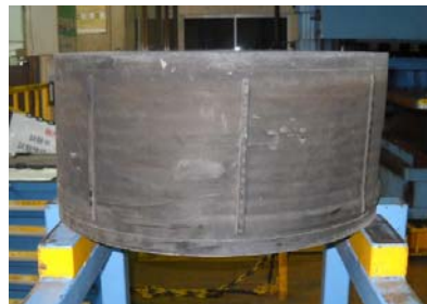
図-3.6 回収した A1G2 支承の外観
