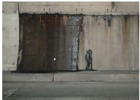
写真-2 観察箇所における漏水の発生状況
