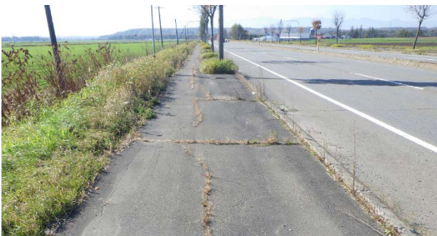
写真-2 歩道の凍上ひび割れおよび低温ひび割れ
