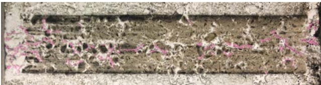
写真-1 ひび割れ率 20% 時の混合物の表面状態
